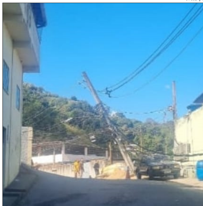
O POSTE caiu após ser atingido durante uma obra e a rua ficou interditada
