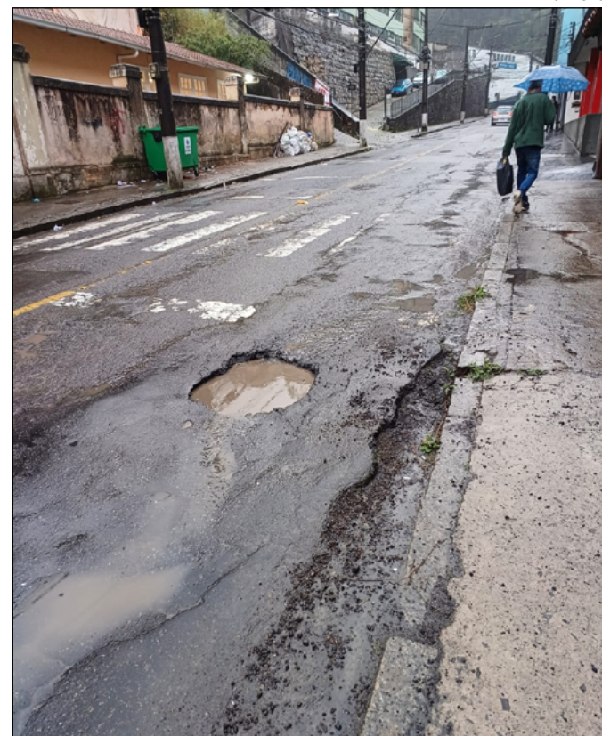
BURACOS, faixa de pedestres apagada e falta de quebra-molas
