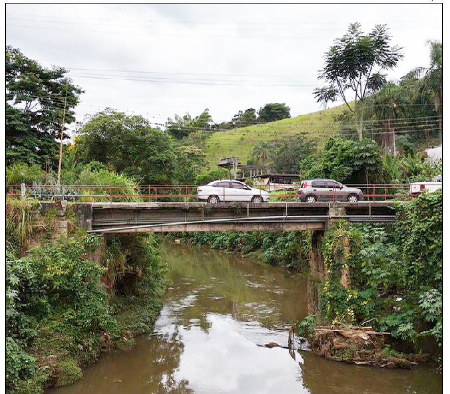
TÉCNICO recomenda mudanças emergenciais no tráfego na Ponte do Arranha-Céu
