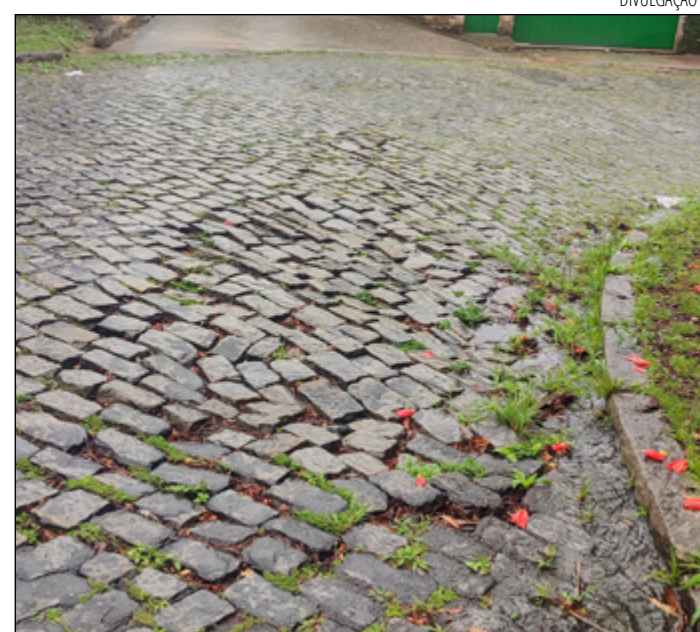
A RUA está cedendo e preocupa moradores e motoristas
