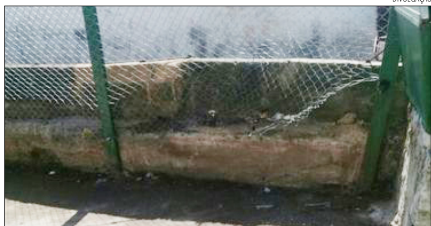
O DESPEJO irregular de entulhos acabou danificando o alambrado
