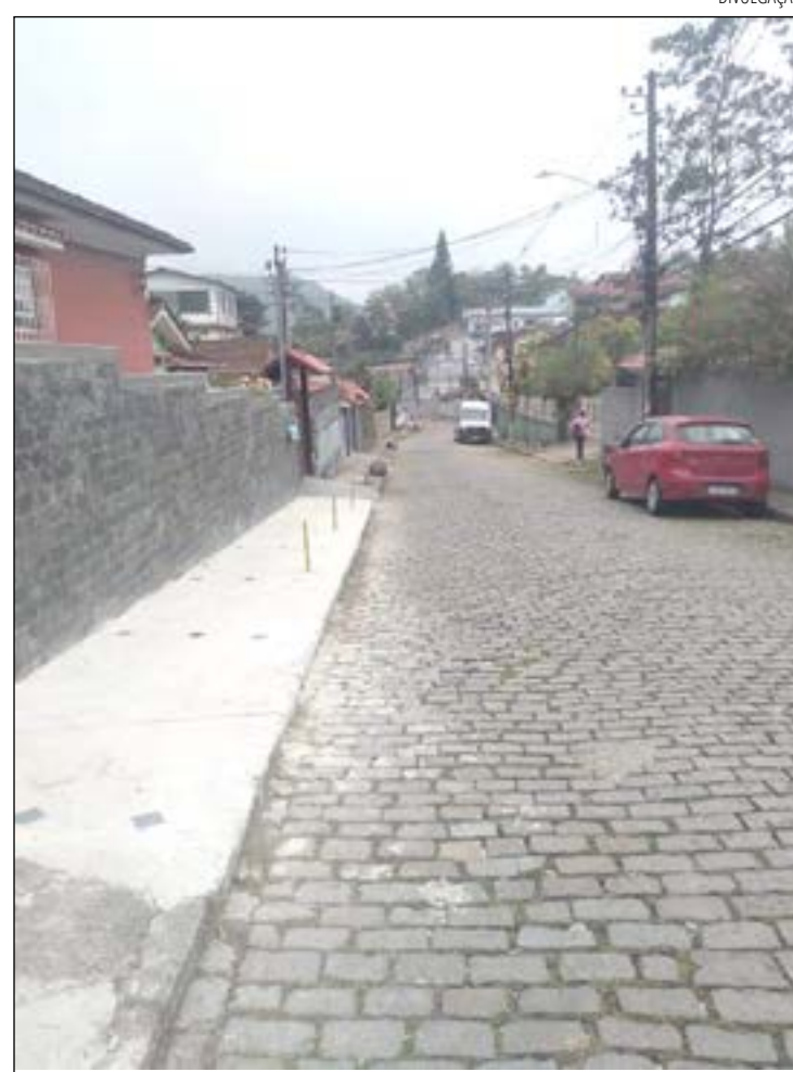
RUA RAUL VEIGA, no Quitandinha, apresenta desnível em um trecho
