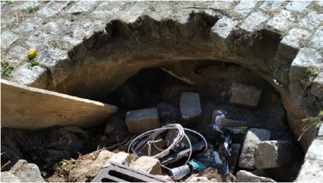
FORAM necessárias seis pessoas para tirar o carro que ficou danificado ao cair no buraco
