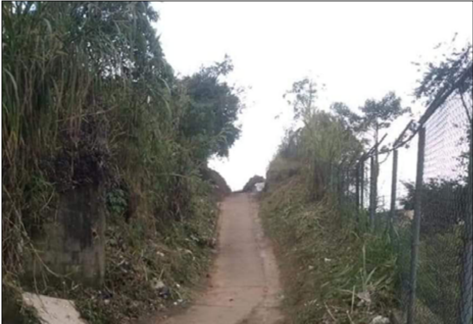
DEPOIS DE retiradas as barreiras foram percebidos problemas estruturais
