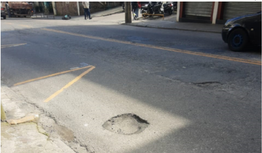
COM O grande movimento de veículos na rua o buraco abriu novamente
