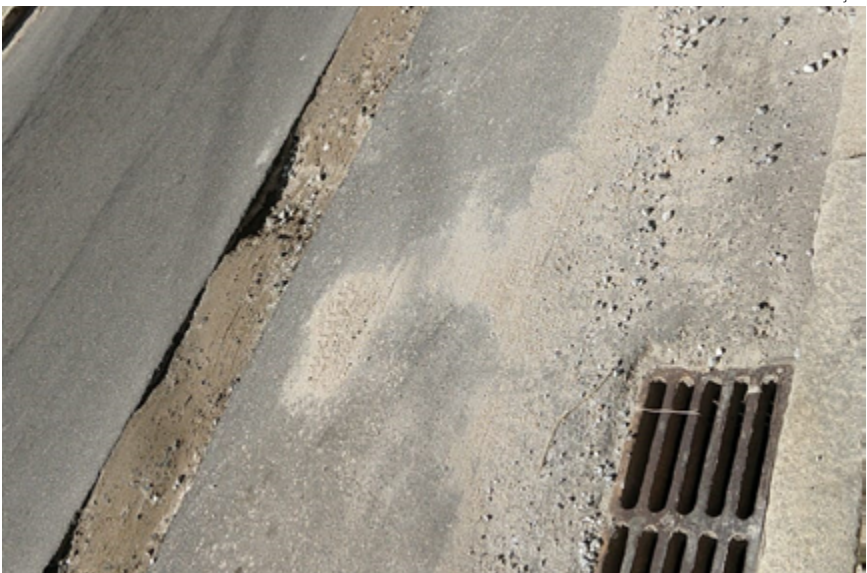
REMENDO causou um ressalto na rua e na calçada, reclamam transeuntes
